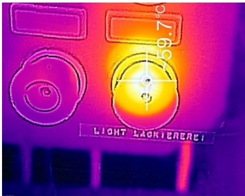
Abb. 24.2 Verteilung mit Diazed-Sicherungen; Thermographiebild
