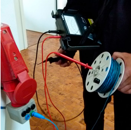
Abb. 8 Messung der niederohmigen Schutzleiterverbindung
